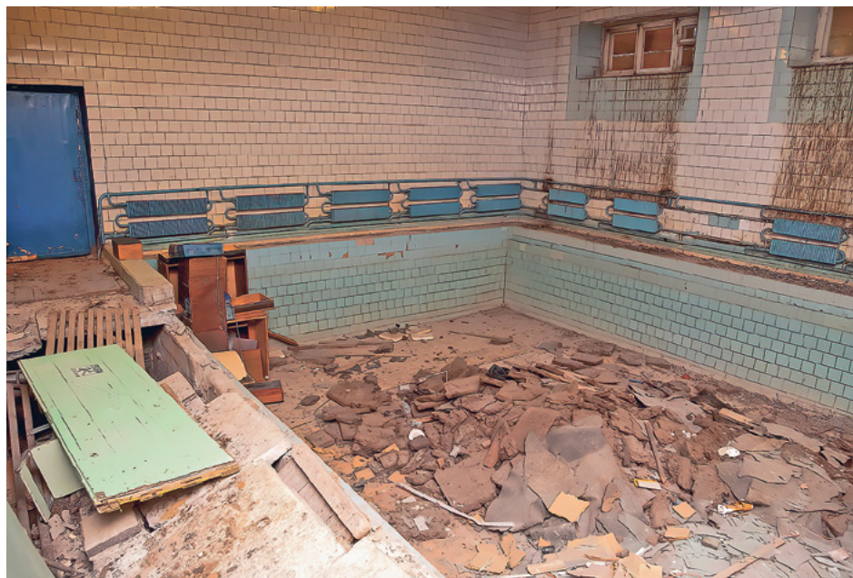
Бассейн в школе №28 работал до конца 2005 года. Теперь он нуждается в капремонте
